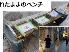
壊れたままのベンチ
